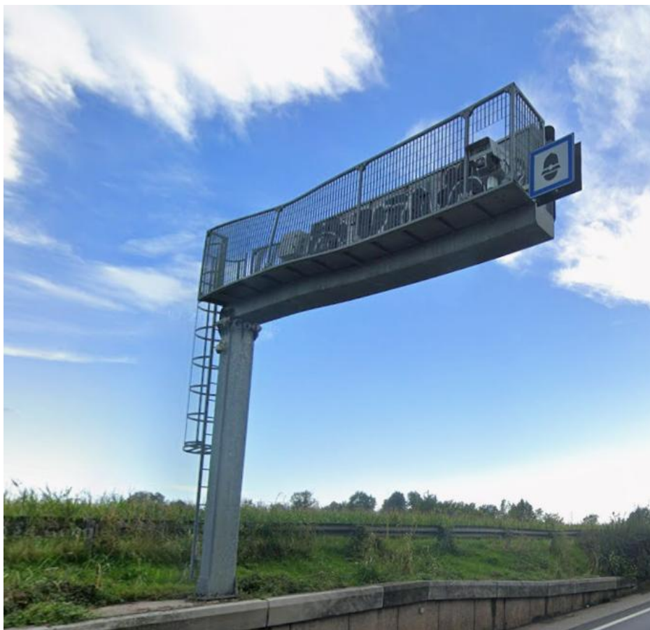
Figura 10 - Cartello sopra strumentazione direzione BS
